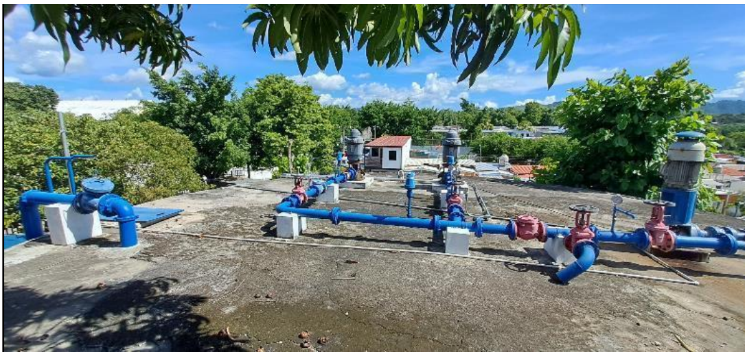
Imagen 29. Equipos de bombeo sobre Tanque
