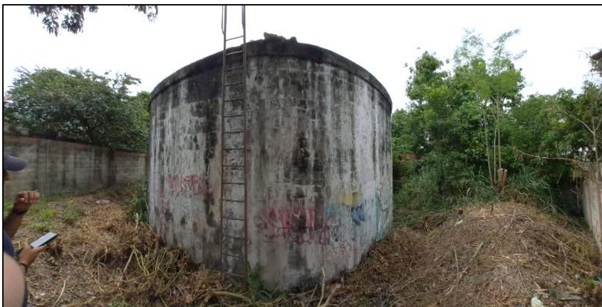
Imagen 32. Tanque Santa Rita
