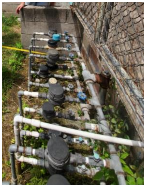
Imagen 10. Referencia de instalación actual de medidores en condominios
